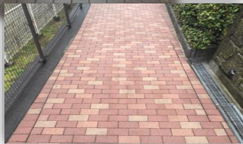
泥が蓄積したインターロッキング
