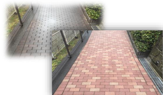
泥が蓄積したインターロッキング
